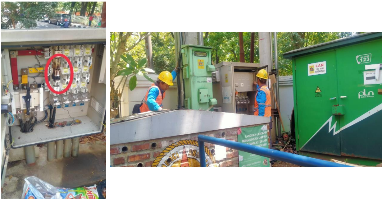
Gambar Kerusakan Gardu PLN
